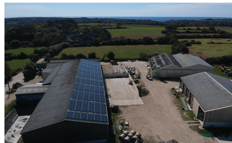
Figure 57 : Centrale PV de 100 kWc à Kergalédan (Source : Energies-partagées)
