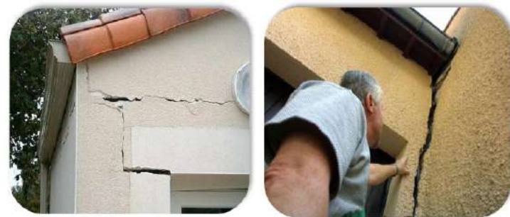
Figure 136 : exemple de dégâts causés par le retrait gonflement des argiles sur l'habitat - groupe SMA (gauche) et MEDD (droite)
